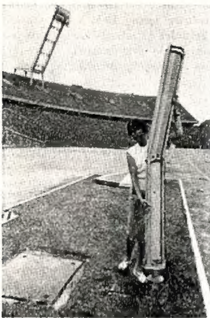
Rys. 10. Osadzenie kolumny dźwiękowej do nagłośnienia stadionu sportowego
